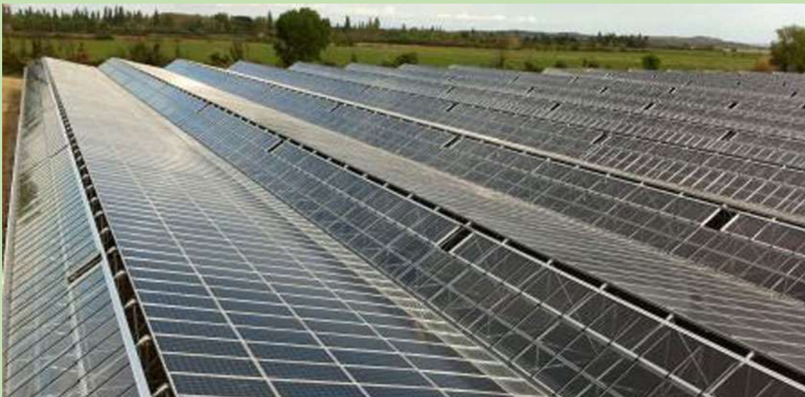
El techo de un invernadero con placas solares
