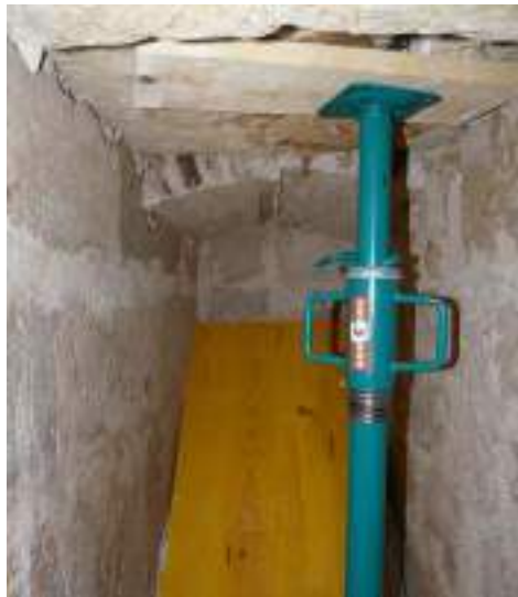
Puntal de suport col·locat a l'interior de la tomba per prevenir el trencament i la caiguda de les lloses existents sota la làpida
