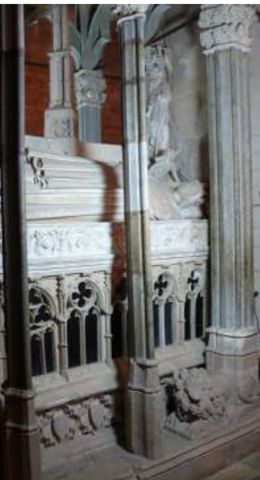
Columna del baldaquí de la tomba de Jaume II, on es veu la curvatura o desplaçament de l'estructura
