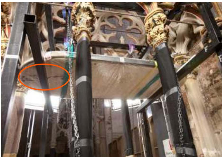
Vista general de la llosa, disposada sobre els rails metàl·lics on s'observa l'emascarat del fum de les espelmes associat a l'obertura de 1857
