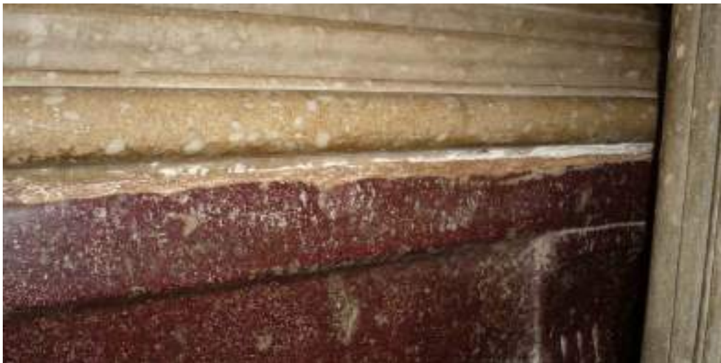
Tancament amb guix entre la tapa i la banyera
