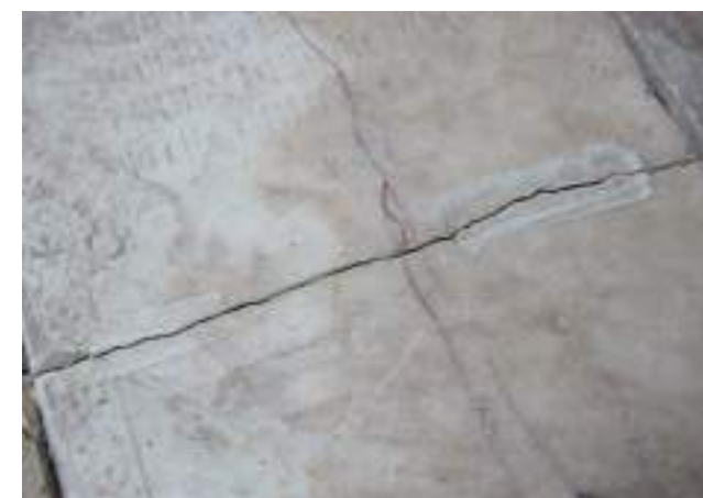
Fissures existents a la làpida
